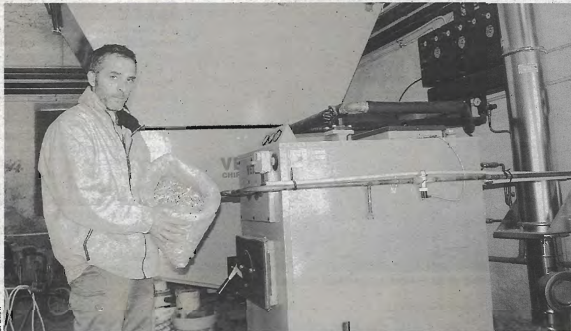
Robert Gilli, devant sa chaudière et le silo qui l'alimente en déchets de bois.
